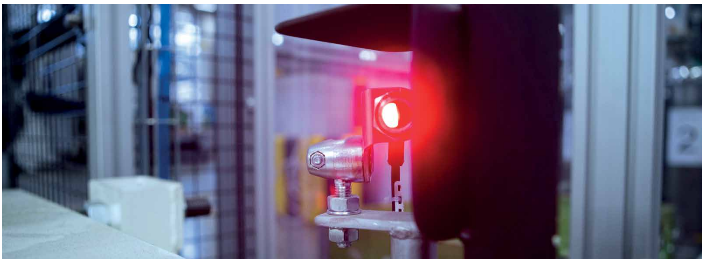
Anna Nilsson visar med handen hur en ljusråd för personskydd fungerar. Bilden uppe till höger visar säkerhetskomponenter som styr samtliga skydd i anläggningen, och nederst, en fotocell placerad på bansystemet.
